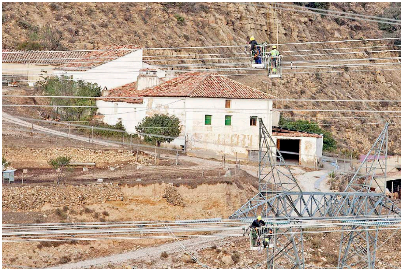
El brunzit del cablejat de molt alta tensió se sentirà des d'alguns habitatges de Morella / MIGUEL ÀNGEL TRONCHO
