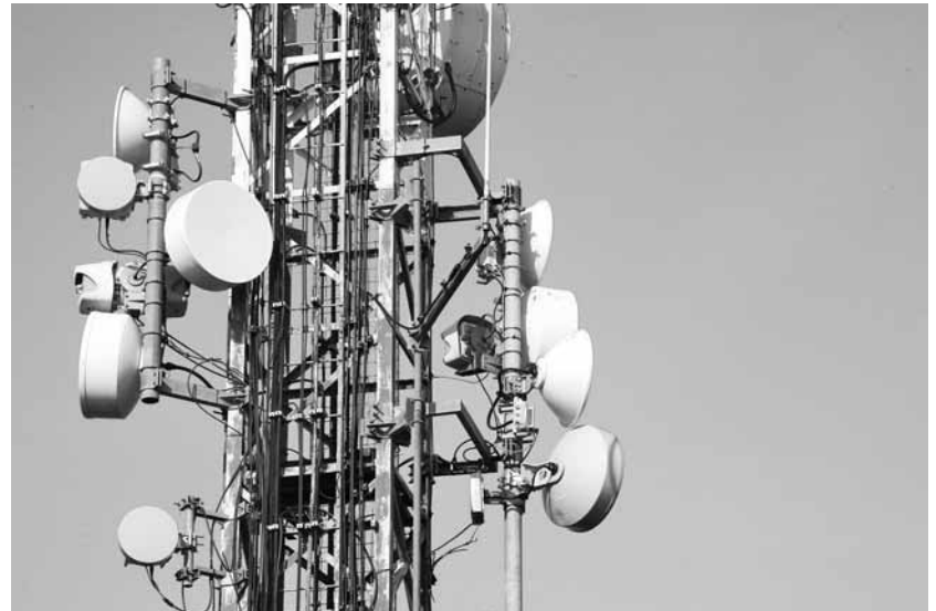
Torre de telecomunicacions situada al Turó de la Rovira
