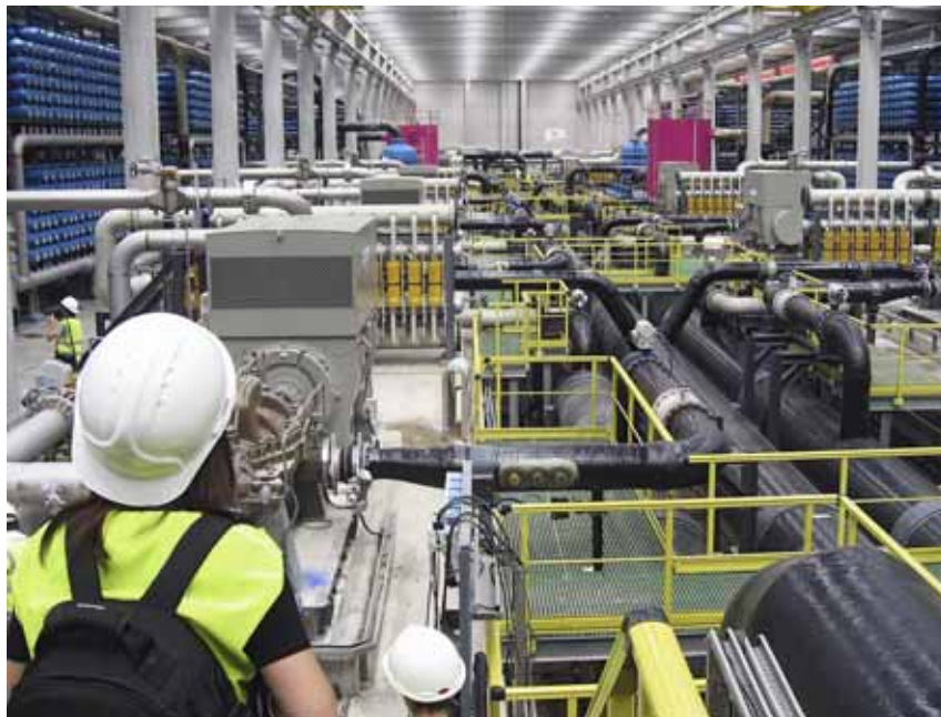
Aigües Ter-Llobregat és propietària d'instal·lacions potabilitzadores i de plantes de dessalinització com la del Prat de Llobregat
