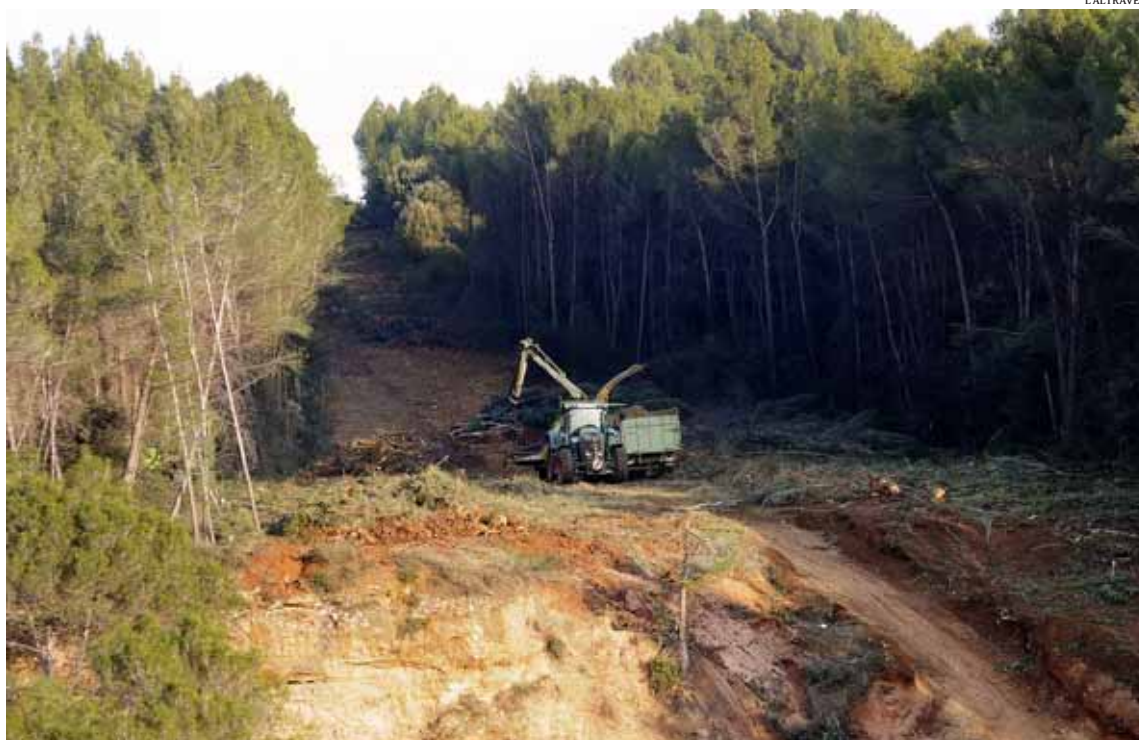
Afectació de les obres del gasoducte Martorell-Figueres a la zona del torrent de Colobrers a Castellar del Vallès
