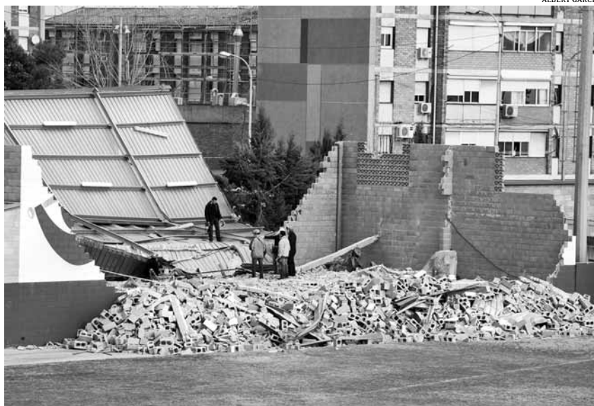
La pràctica totalitat de blocs estaven buits i sense barres de ferro per a reforçar l'estructura
