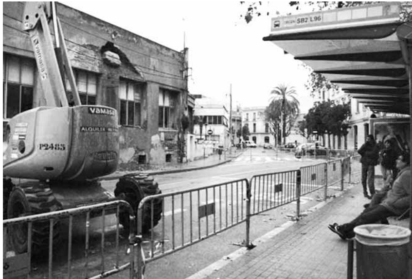
Imatge de la façana deteriorada de l'Ateneu Santboià
