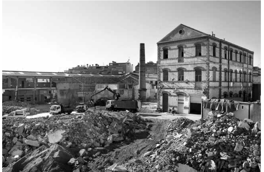
Panoràmica de la fàbrica de Can Fàbregas amb les excavadores fent feines d'enderroc i desmuntatge
