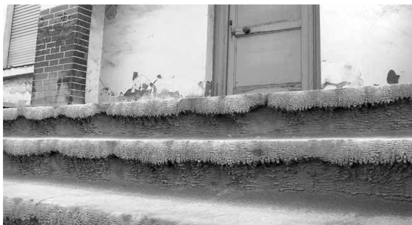
Les escales d'aquesta casa estan cobertes per una capa gruixuda de pols de ciment que ha quedat solidificada
