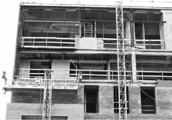
Les obertures no estan protegides amb xarxes que evitin la caiguda de les operàries
