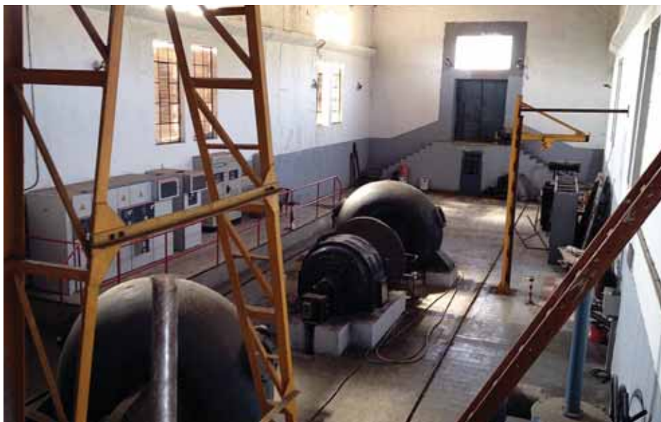
Som Energia ha aconseguit una concessió de la central hidroelèctrica de Valteina (Valladolid) finançada amb aportacions voluntàries de les seves sòcies / SOM ENERGIA
