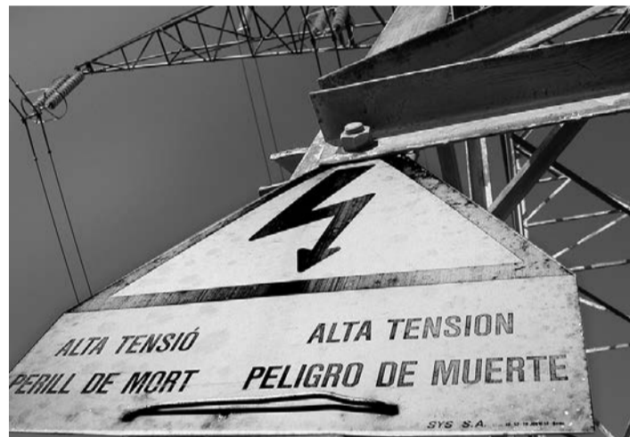
Detall d'un pal elèctric de la MAT
