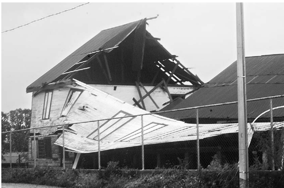
Estat d'un dels edificis menys afectats per l'huracà Félix a Bilwi
