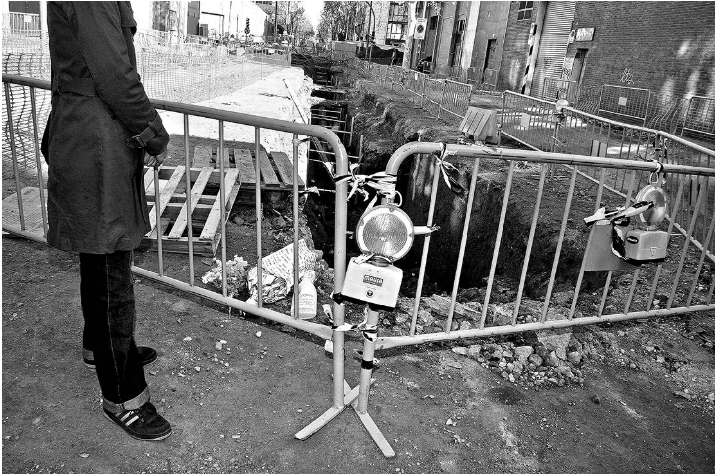
El carrer Llull 66, el lloc on es va produir la mort d'un treballador de les obres
