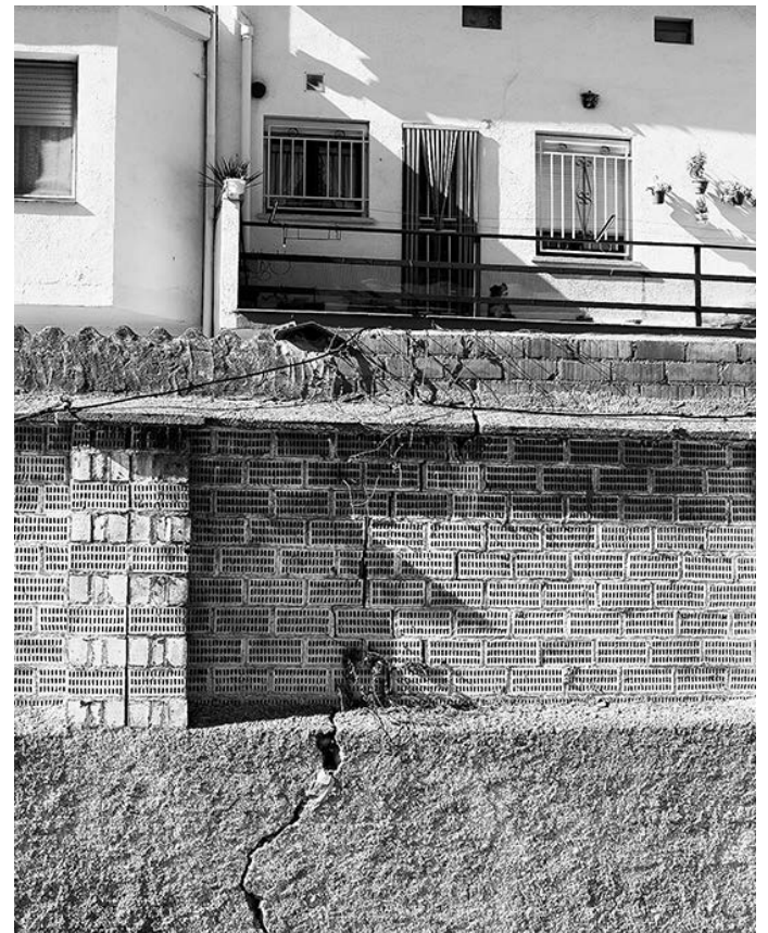
L'exterior dels habitatges també està malmès
