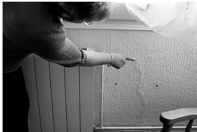
Esquerda d'un habitatge afectat
