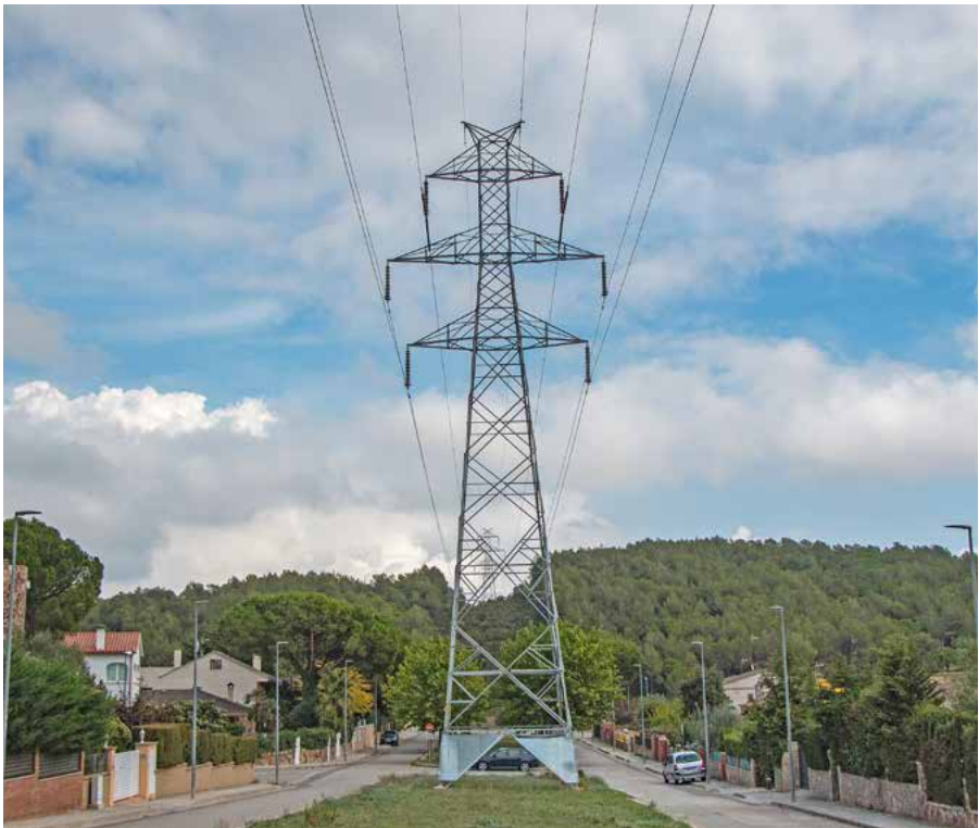
La MAT de Tarragona arribaria fins a la subestació de Begues, on ja conflueixen nombroses línies elèctriques a tocar dels habitatges. / ADRIANA PIMENTEL @Adriana_Pimente
