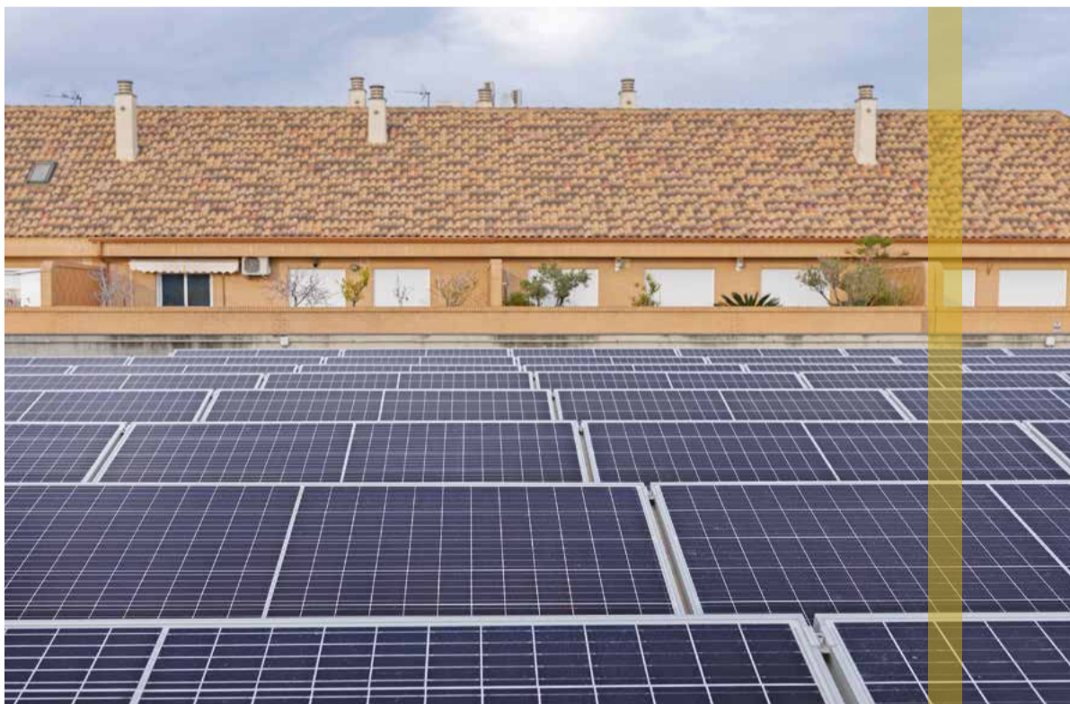
Les plaques solars, ubicades al sostre del centre cívic de Castellar, donaran servei a seixanta famílies, una nau de producció agrícola i altres entitats del poble. A més, una part de la producció es destinarà a cobrir les necessitats de famílies amb risc de pobresa energètica.
