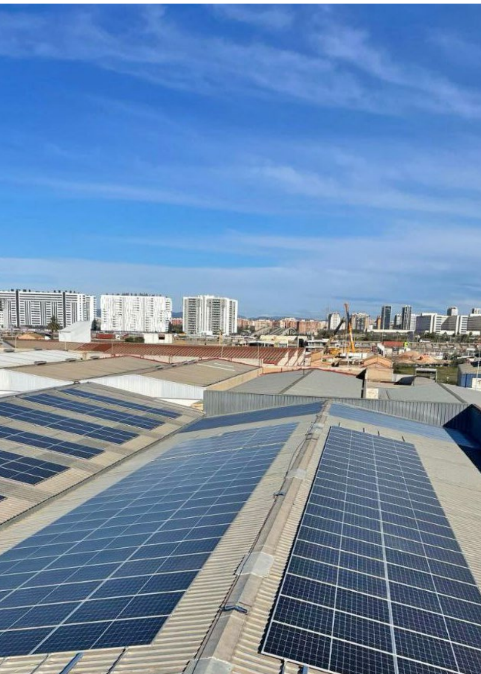
La CEL del barri de Castellar-l'Oliveral de València ha instal·lat panells solars en edificis municipals i naus industrials.
